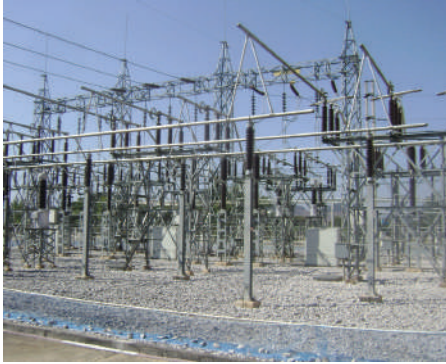
ลานไฟฟ้า
