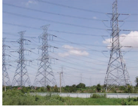
เสาไฟฟ้า
